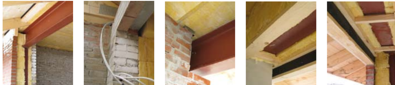
Omhyggelig tilpasning af isoleringen omkring stålsøjlerne er nødvendig for at sikre mod linietaf langs profilet.
